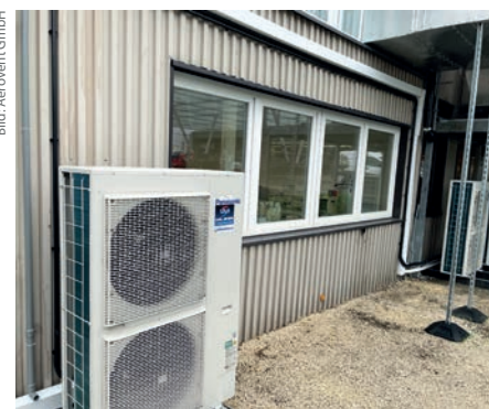
Bild: Aerovent GmbH
